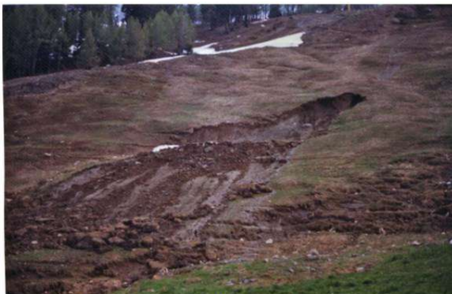
Fenomeno di frana avvenuta a monte di Plan Checrouit nell'ultima decade del maggio 1989. Essa è stata innescata da irrazionale distribuzione delle acque delle scoline della Pista di Coppa del Mondo.
